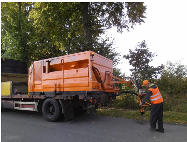
Zakupiony remonter drogowy do bieżących napraw ubytków w nawierzchniach dróg powiatowych
