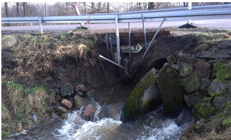
Zniszczony przepust w ciągu DP 1397N w m. Wyszkowo
