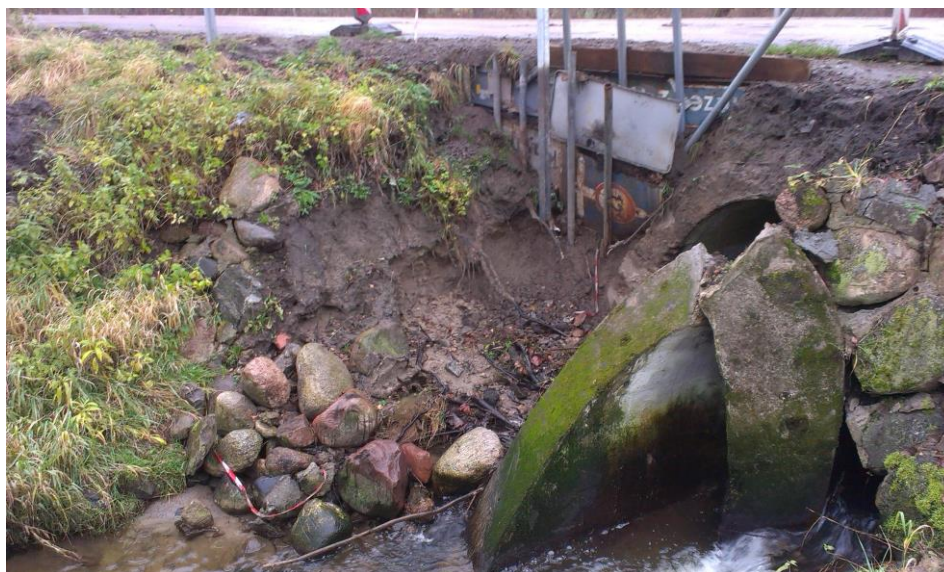
Przepust w ciągu DP 1397N Wyszkowo zniszczony, do odbudowy w 2014 roku
