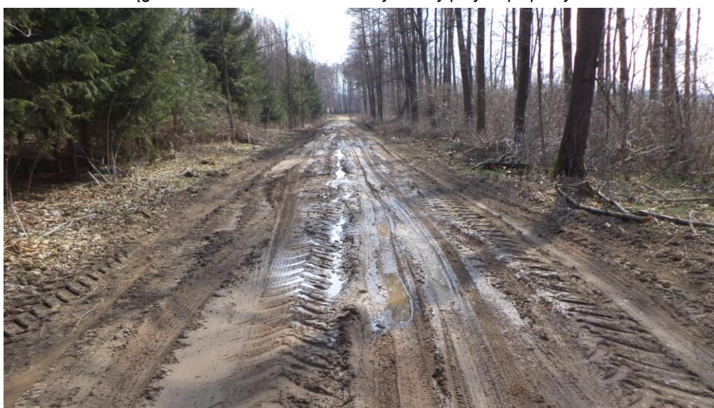
Zniszczenia na nawierzchniach dróg gruntowych- przed profilowaniem równiarką
