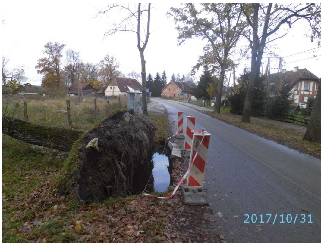
Fot.2. Uszkodzenie pobocza DP 1158N msc. Słobity
