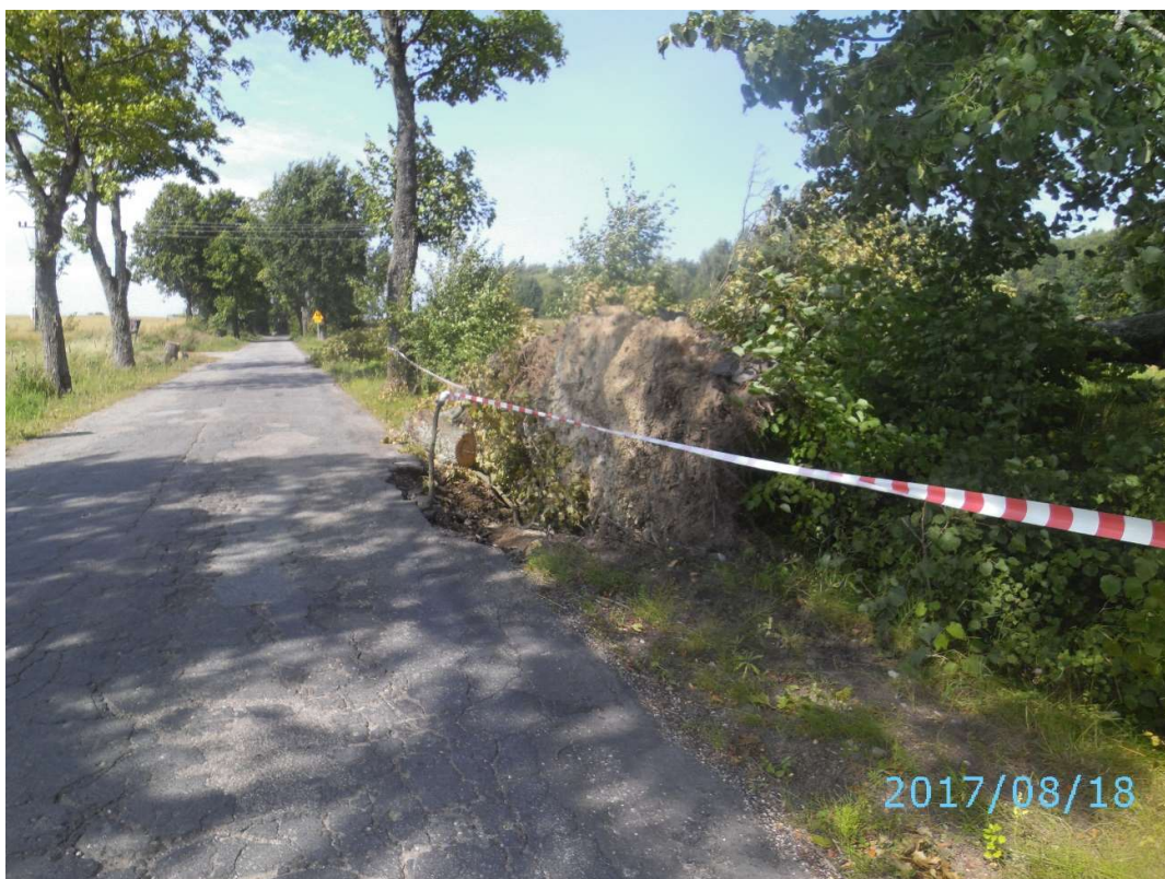
Fot.4. Uszkodzenie krawędzi jezdni i pobocza drogi DP 1352N
